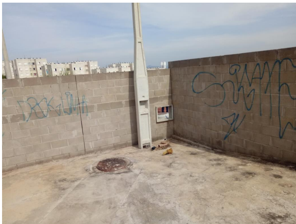
Figura 6 - Poste de entrada de energia e caixa do hidrômetro (ambos nunca foram ligados)
