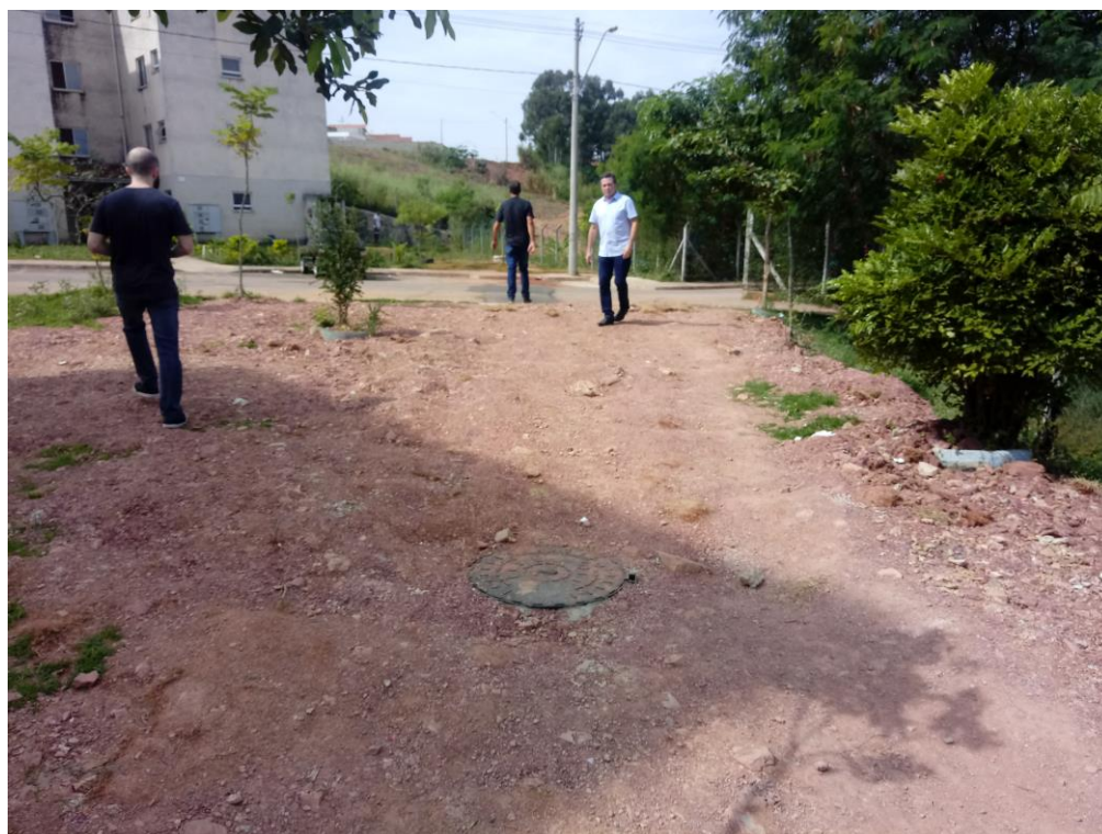
Figura 16 - Último poço de visita (da nova rede de esgoto instalada) a qual não é possível identificar o local de despejo de esgoto proveniente da EEE Vem Viver
