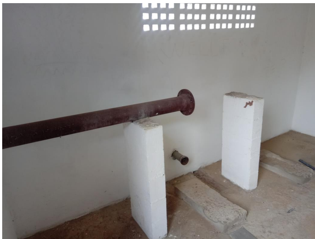
Figura 4 - Local onde deveria estar instalado o conjunto de motobombas (nota-se que o local não possui furos no chão, o que comprova que os equipamentos nunca foram instalados)
