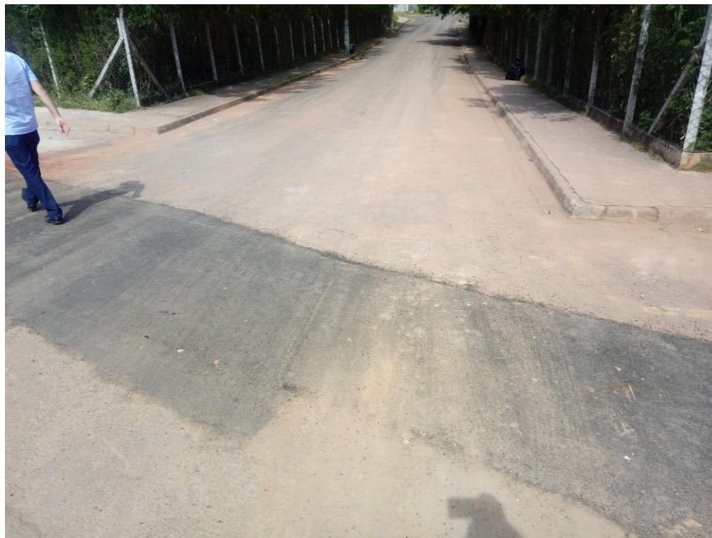
Figura 15 - Rua no interior do Condomínio onde foi "passada" a nova rede de esgoto
