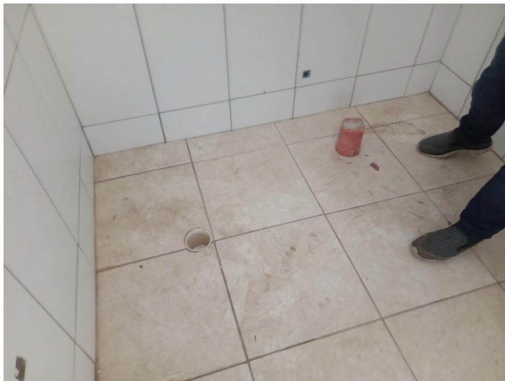
Figura 5 - Sanitário da EEE (nota-se que no local não existe furos no chão, o que comprova que nunca foram instalados a pia e vaso sanitário)
