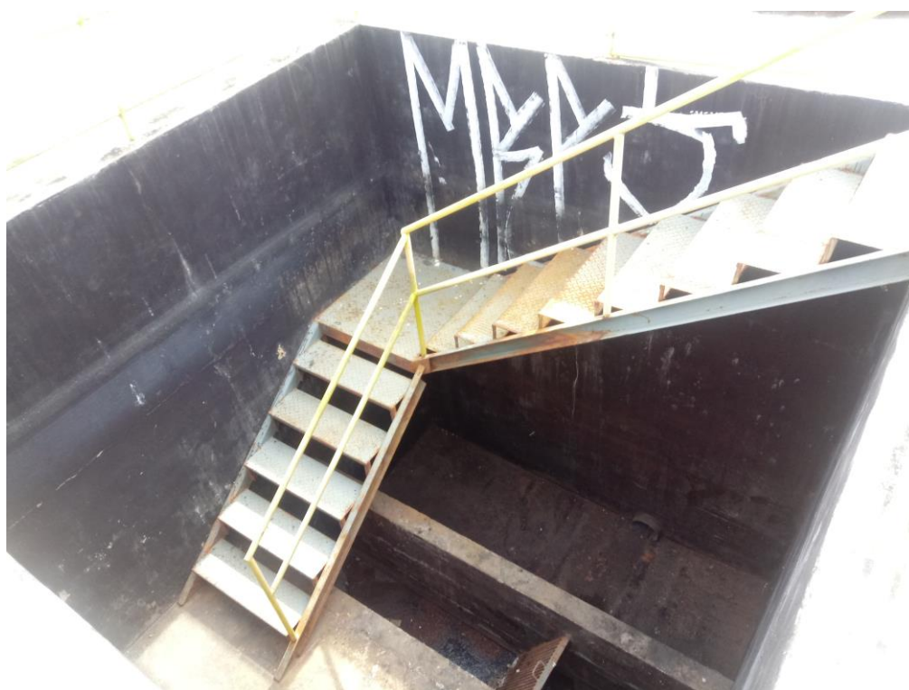
Figura 2 - Tanque de armazenamento de esgoto da EEE Vem Viver
